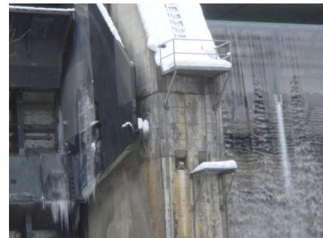
Detail des Lagers der Segmentschütze
